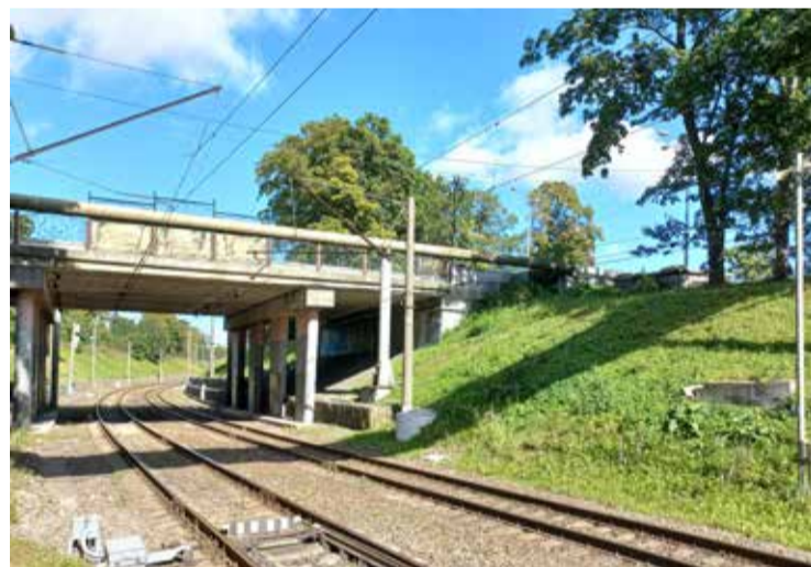
Мост на ул. Генерал-фельдмаршала Румянцева. Вдоль железнодорожных путей (слева) шла улица Erlichshausenstraße.
